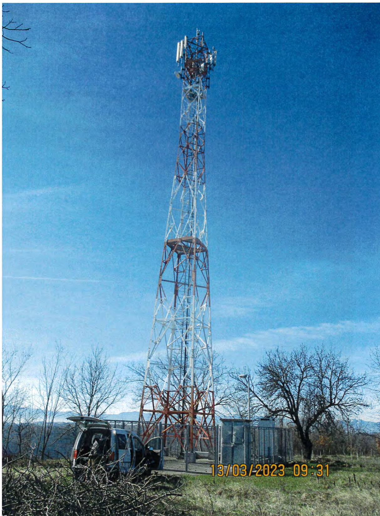
Slika 3: Prikaz antenskog stuba na kom se nalazi antenski sistem bazne stanice Babina Luka, operatora Telekom Srbija
