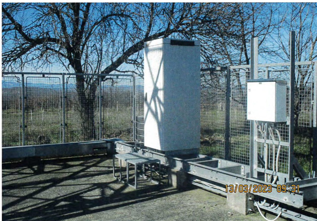
Slika 5: Kabinet bazne stanice Babina Luka operatora Telekom Srbija
